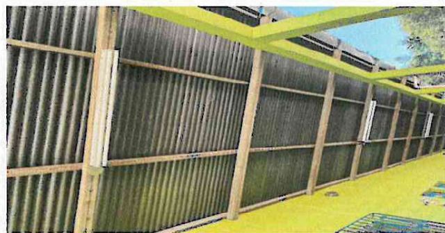
Foto 8: Sustitución de lámparas por plafoneras, están quemadas y es muy necesario tener electricidad ya que en nuestra aldea cae mucha nieblina y las aulas se oscurecen.
