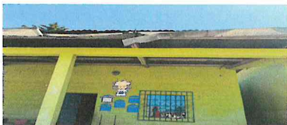
Foto 3: Sustrucción de canales de metal. Todos los canales ya estan en muy mal estado y es muy peligroso ya que se pueden caer.
