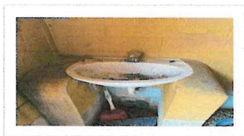
Foto 5: Sustrucción de lava manos, ya esta quebrado
