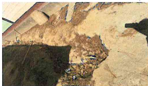
Foto 1: Sustrucción de fosa séptica. ( ya colapso y no hay lugar para realizar un vaciado) sale un mal olor y se regresa para los sanitarios y eso causa contaminación.
