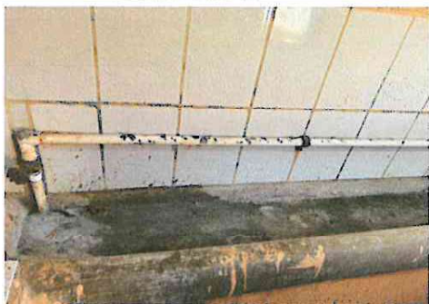
Foto 9: Sustitución en mingitorio no funciona el goteo de agua, ya que siempre pasa con un mal olor
